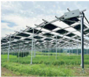
営農型太陽光発電施設
