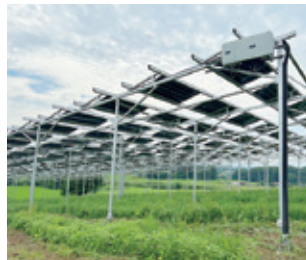
営農型太陽光発電施設
