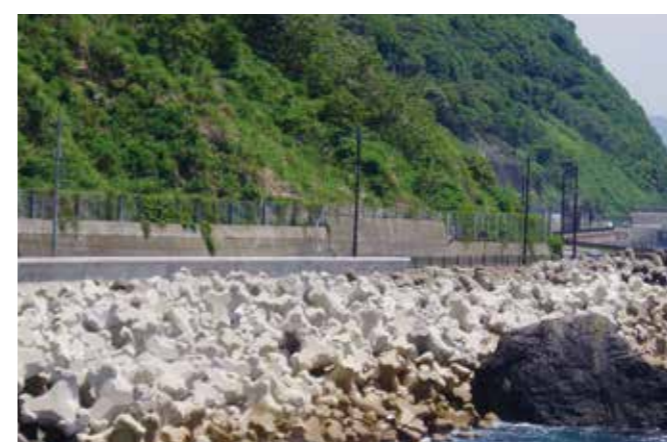
ごぼろがだいら 午房ヶ平道路護岸(福井県) 施工場所:福井県越前町 事業主体:福井県 施設の種類:護岸 トン型:12t型
