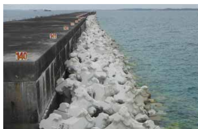
ひらら 平良港(沖縄県) 施工場所:沖縄県宮古島市 事業主体:沖縄総合事務局平良港湾事務所 施設の種類:防波堤 トン型:4t型
