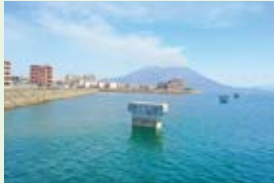
令和元年度鹿児島港(鴨池中央港区)臨港道路橋脚P8下部工事
