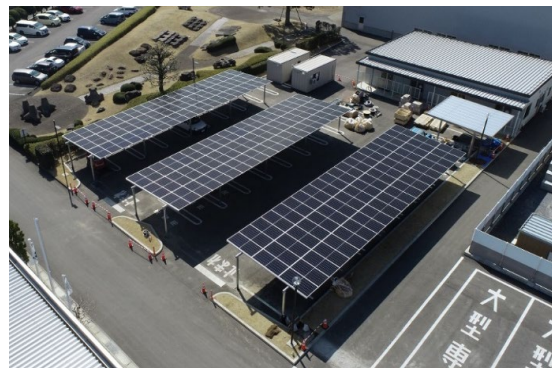
自家消費型太陽光発電設備
