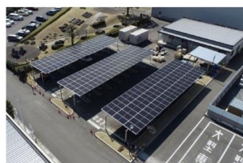
自家消費型太陽光発電設備
