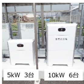
蓄電池設置場所 9台
