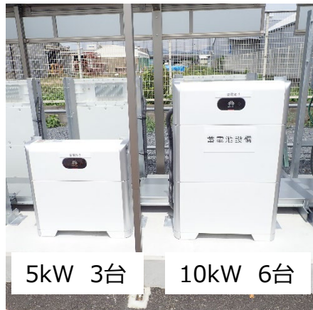
蓄電池設置場所 9台
