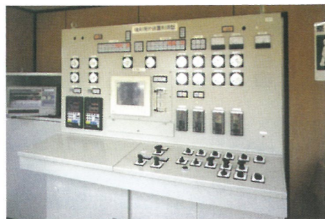
制御盤 Control panel
