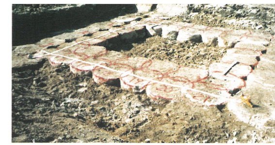
DJM改良柱体頭部 (φ1m) (接円〜ラップ施工) DJM columns'head in shallow excavation
