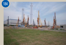
184 東北地方太平洋沖地震による千葉火力発電所ガスタービン発電設備増設工事の内機械台基礎新設工事ならびに関連除去工事 【工期】2011/4~2011/8
