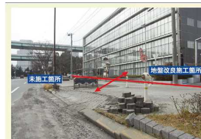
未改良域:段差・噴砂
