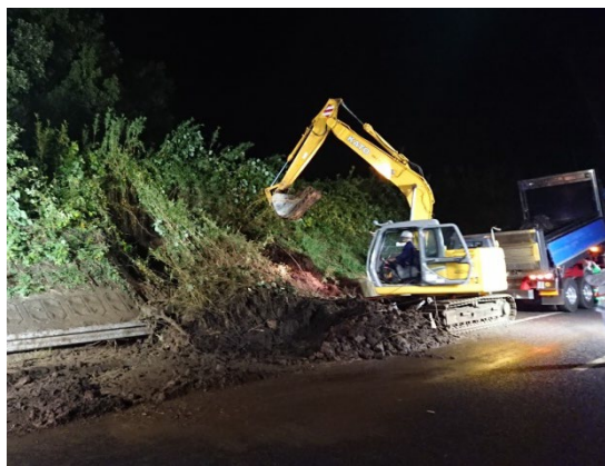
首都圏中央連絡自動車道での被災状況
