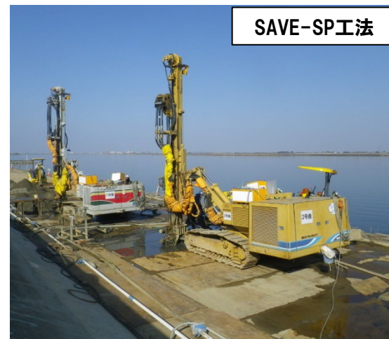
令和元年度木曾川赤地川表高潮堤防補強工事 事業主体:国土交通省中部地方整備局 (元請会社:株式会社新井組)
