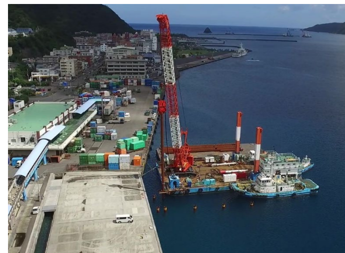
平成30年度名瀬港(本港地区)岸壁(-7.5m)(改良)工事(第3次)(事業主体:国土交通省九州地方整備局)
