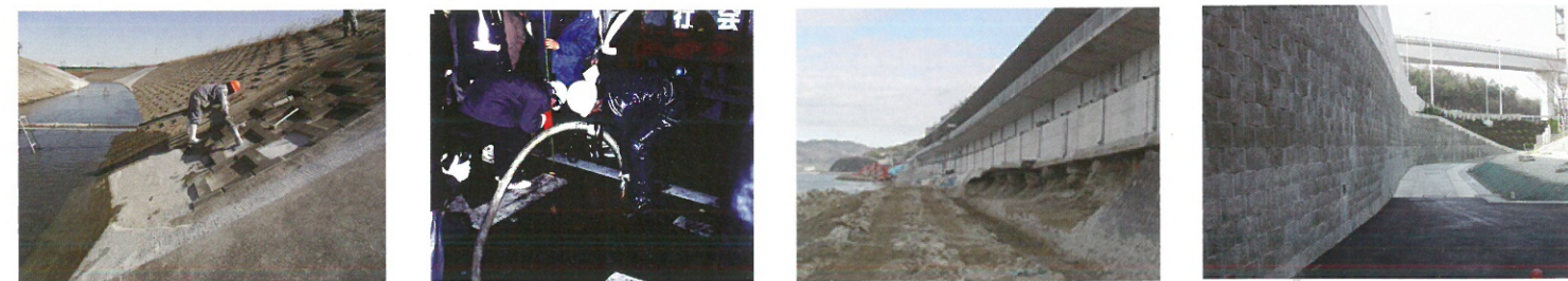
⑰ 護岸空洞補修 ⑱ 路面化空洞充填 ⑲ 洞門基礎補修 ⑳ 土構造物築造
