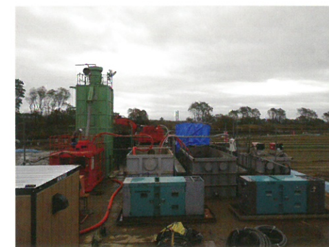
⑥ 中規模仮設プラント
