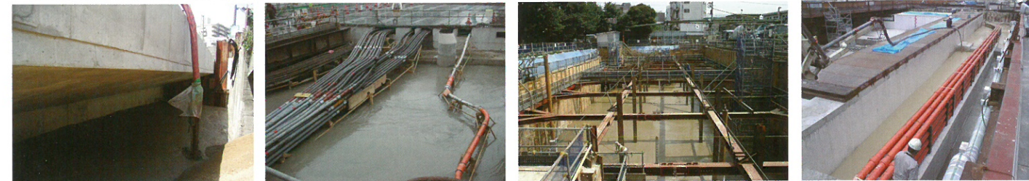
⑤ 橋台背面裏込 ⑥ 広域地盤置換 ⑦ 建築基礎（ラップルコン代用） ⑧ 多条埋設管埋戻
