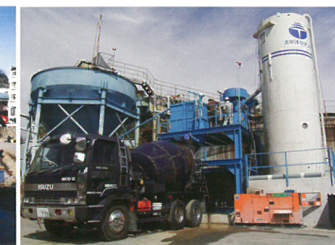
⑧ 簡易常設プラント
