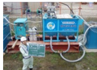
水質監視装置
