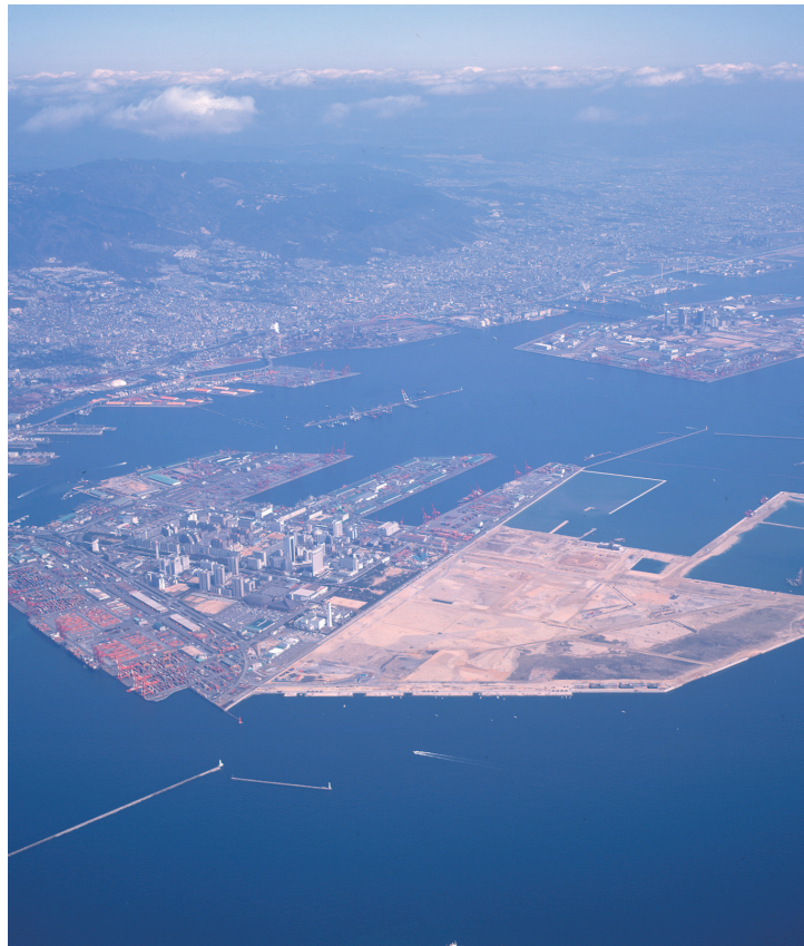
ポートアイランド(神戸市)では支持力の増加、液状化対策を目的にKFコンパクション工法を施工しました。
