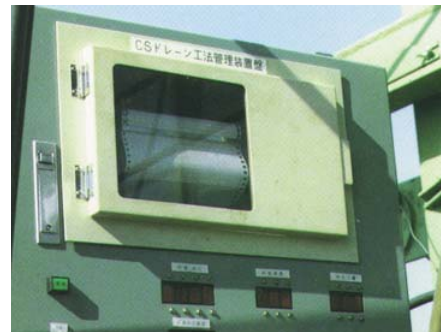
■ 打設機内の管理装置
