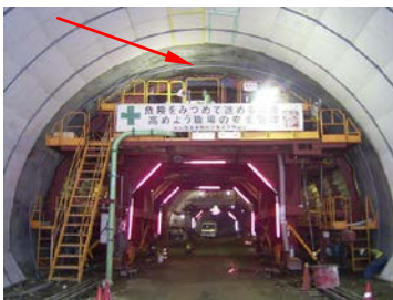
①脱型後、セントルを2m程度移動して支保材を周方向に仮設置
